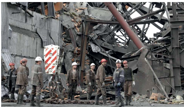
Рис. 34. Разрушение наземных конструкций шахты «Распадская» после взрывов метана
